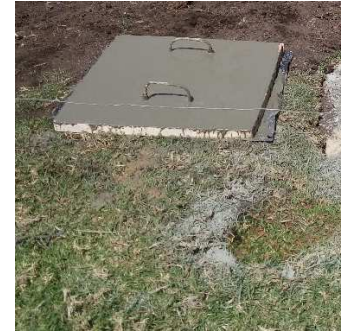
c) Fundida de la caja de inspección.
