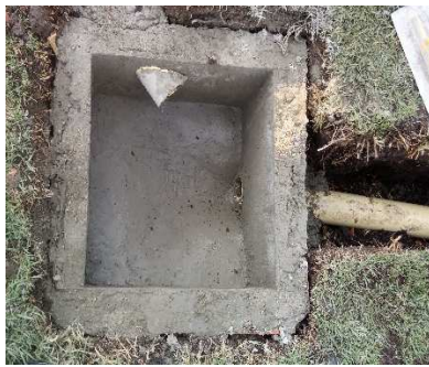
a) Caja de inspección de entrada.
