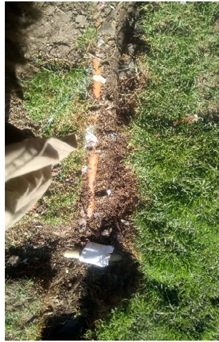
b) Estado actual de la tubería del baño, cocina y lavadero.
