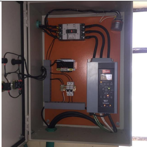
Ilustración 22. Fotografía tablero de control bombeo, Puente de oro.
