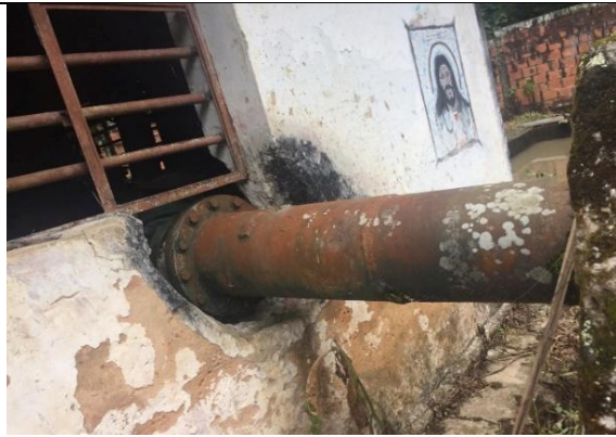
Ilustración 27. Fotografía de tubería de acero que empalma con PVC
