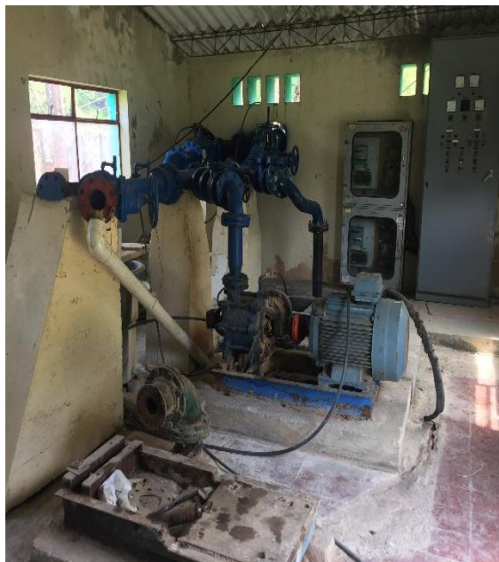
Ilustración 30. Fotografía estación de bombeo Matadero.
