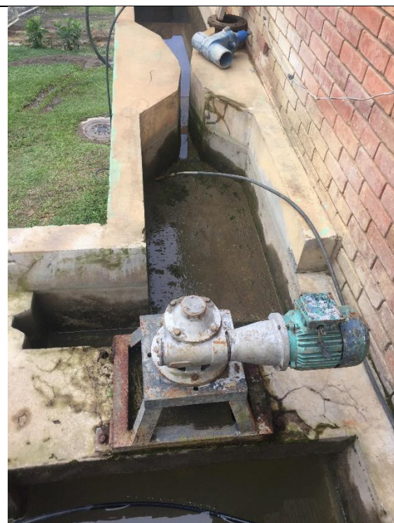
Ilustración 36. Fotografía PTAP Matadero, Canaleta Marshall.
