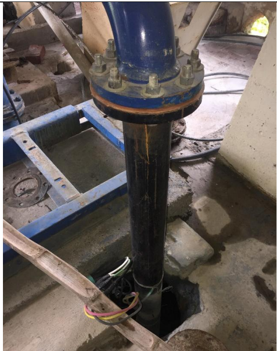
Ilustración 24. Fotografía tubería de la bomba sumergible.
