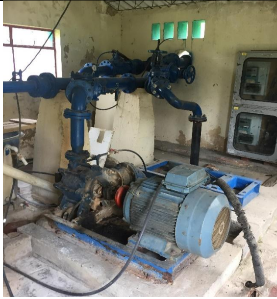
Ilustración 31. Fotografía bomba de estación Matadero.
