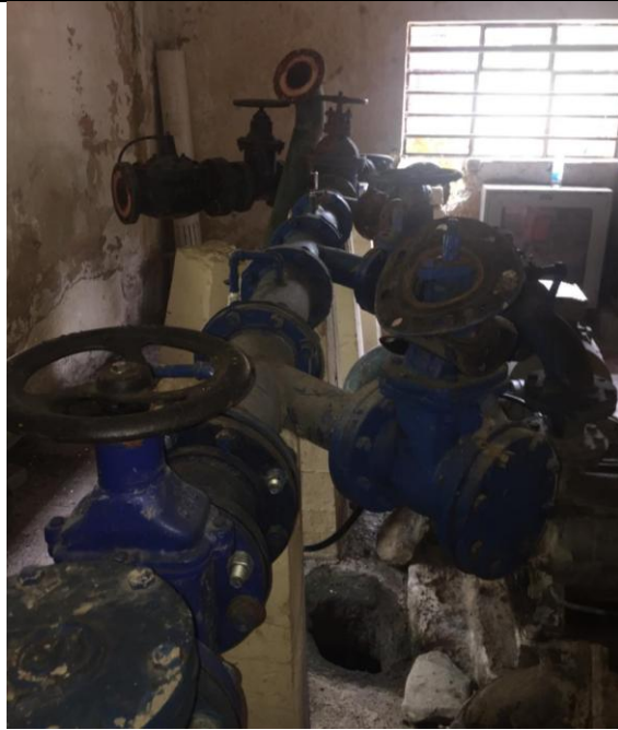
Ilustración 23. Fotografía sistema de conexión de las bombas en tipo flauta.
