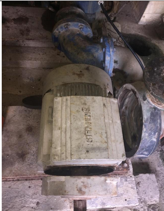
Ilustración 21. Fotografía Bomba, estación Puente de oro.
