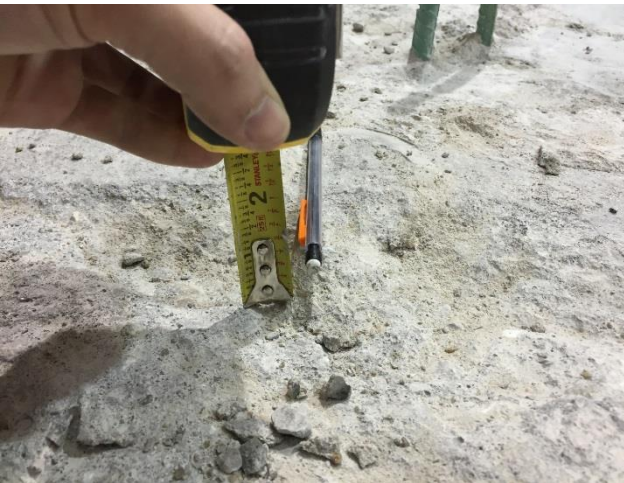
(d) Crater in Girder Top Flange (Girder #1)
