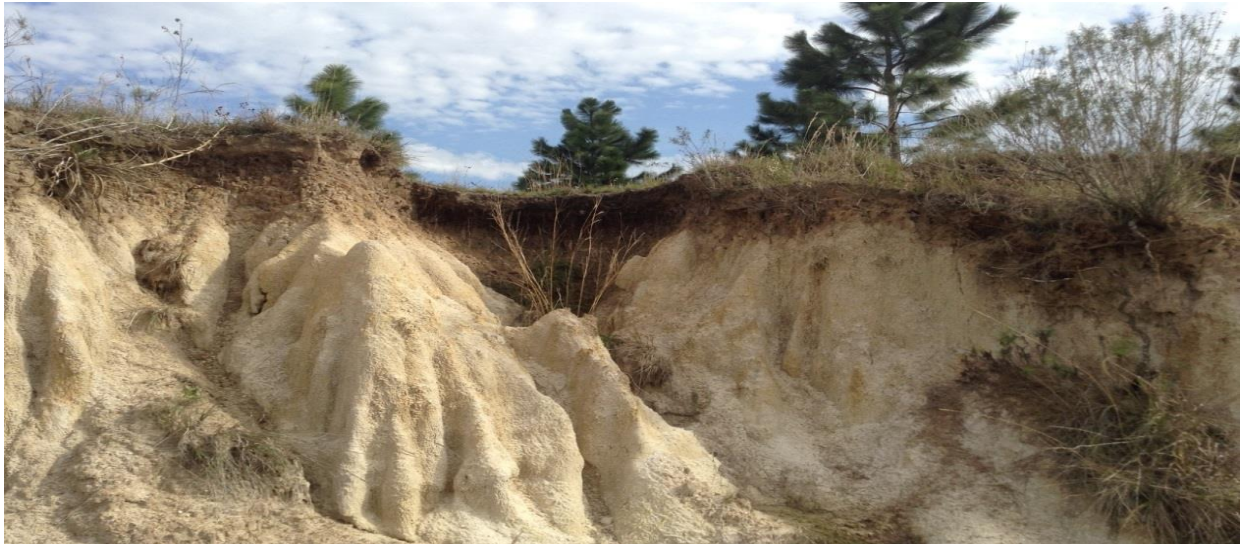
Figura 11 Fotografia da feição produzida pela erosão interna do solo. Foto: ARDUIN, Ricardo (2017).
