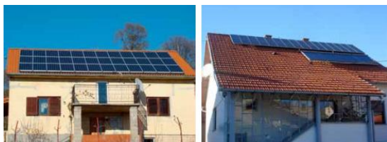
Slika 2. Fotonaponski moduli na krovu, lijevo 6,12 kW i desno 6,72 kW
