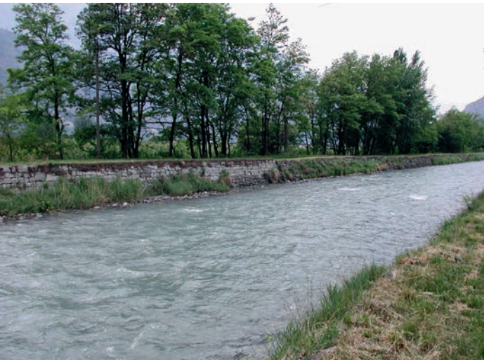
Figure 3: Exemple de digue remblayée, à l'aval du pont CFF. | Bild 3: Beispiel eines aufgeschütteten Deiches, talwärts von der Eisenbahnbrücke.
