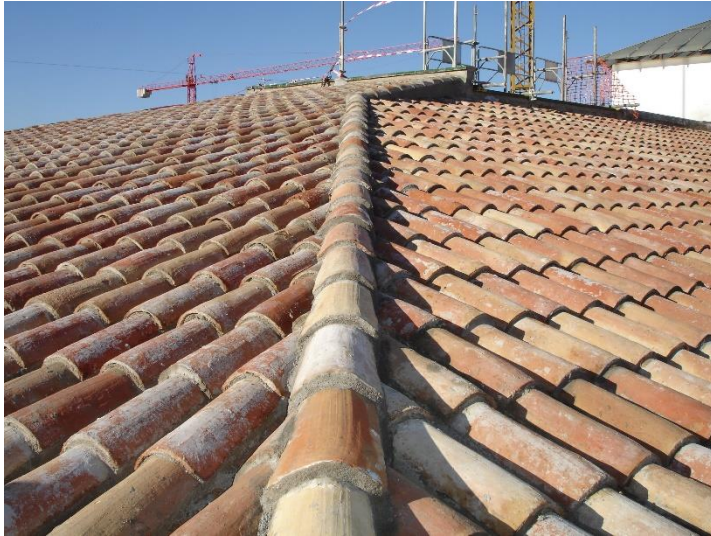
IMATGE 60: Vista general de la teulada de les crugies A i B, durant les obres de rehabilitació del 2010.
