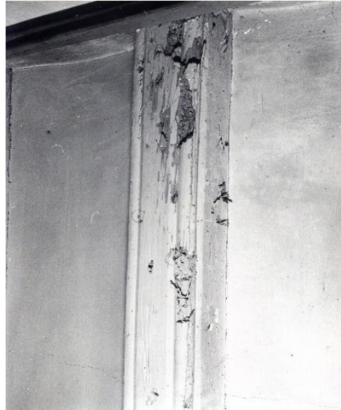
IMATGE 142: Biga del sostre de la biblioteca afectada per tèrmits.
