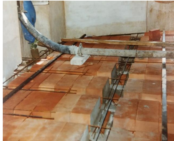
IMATGE 156: Detall del procés de construcció dels nous forjats del terra del tercer pis. Revoltons ceràmics damunt les biguetes de formigó i les cadenes de ferro.
