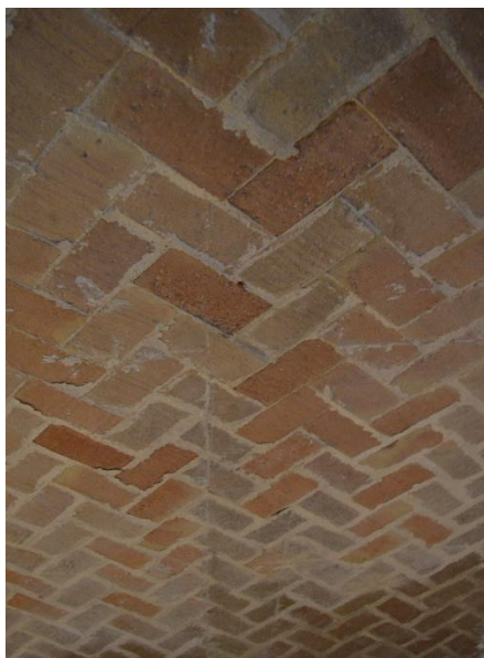
IMATGE 57: Detall del sostre de maó pla del celler de la planta baixa, en el seu estat actual.
