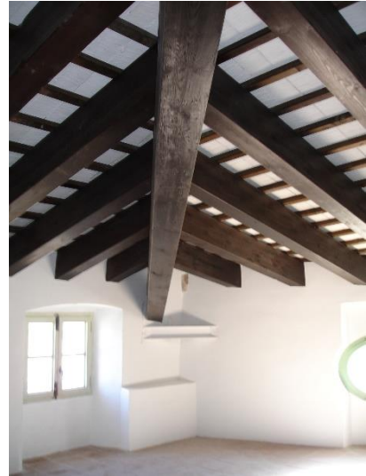
IMATGE 61: Detall de l'enllatat de la coberta, de les crugies A i B, durant les obres de rehabilitació del 2010.
