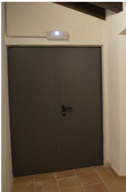
IMATGE 196: Noves portes talla-focs, que separen la zona d'accessos per l'escala nova de les diverses planes.
