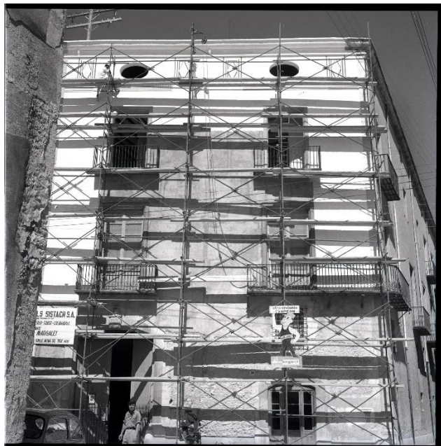
IMATGE 134: Treballs de restitució de les pintures murals de la façana del carrer Major. el 1964.
