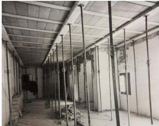
IMATGE 157: Vista del procés de construcció del nou forjat (apuntament) del sostre del 2n pis, el 1986.
