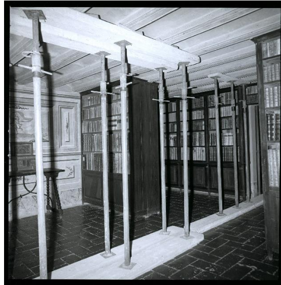
IMATGE 139: Imatge dels apuntaments del sostre de la biblioteca, l'any 1974.
