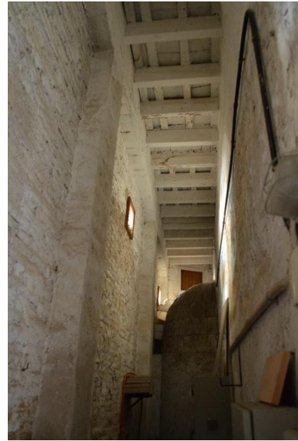
IMATGE 94: Estat actual de l'interior de la galeria del jardí.
