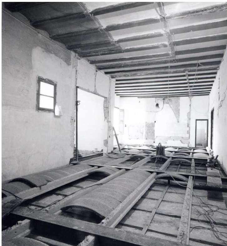
IMATGE 153: Vista d'una de les sales del 2n pis, durant la intervenció del 1983. Es poden veure les jàsseres de ferro de paret a paret, les biguetes de formigó i els revoltos ceràmics.
