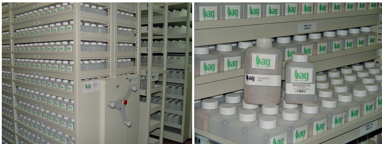
Figura 5. Câmara fria, após as reformas, mostrando as estantes deslizantes utilizadas para armazenamento dos acessos de arroz e feijão.
