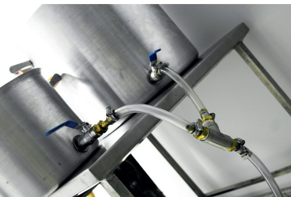
Figura 11. Mangueiras conectadas às saídas dos dois tanques e unidas por um acessório na forma de “T”.
