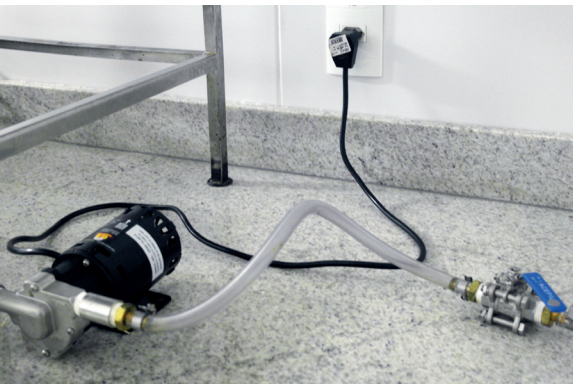
Figura 17. Segmento de mangueira conectando saída da bomba (8) à entrada da válvula (9).
