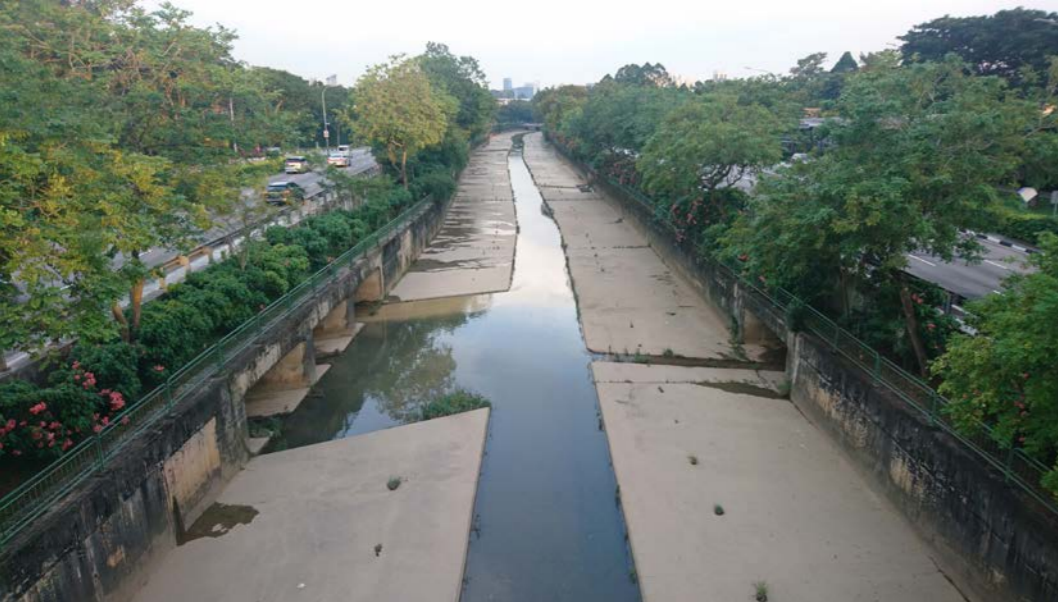
FIGUR 20. KANAL FÖR LEDNING AV VATTEN VID MOTORVÄG. ROCHOR RIVER, SINGAPORE.
