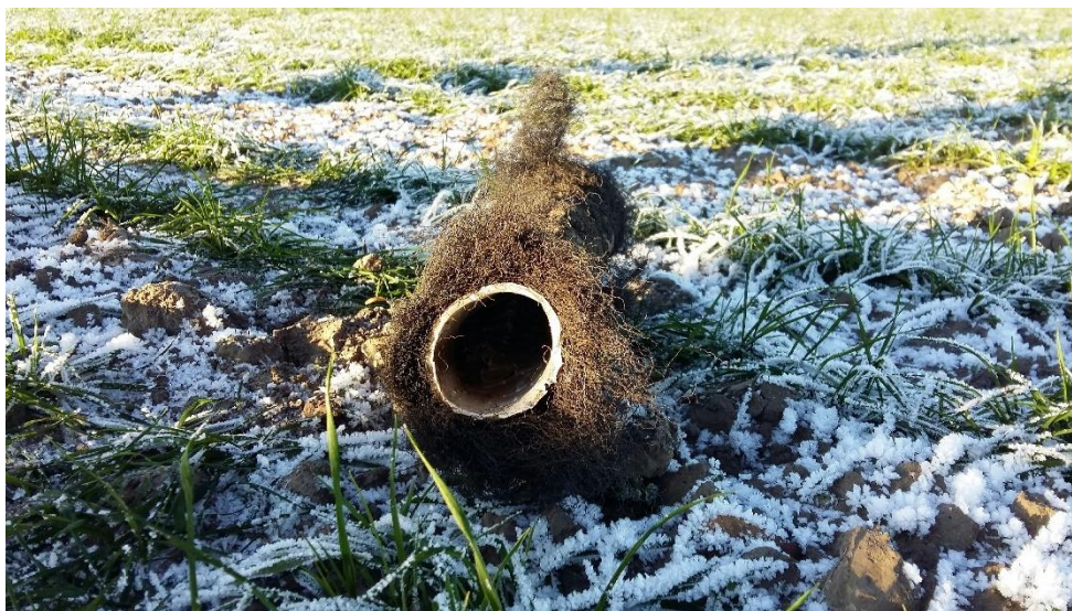
Figur 6. En avskuren bit av dräneringsledning 7 med ett svart och relativt voluminöst syntetiskt omlindningsfilter. Foto: Hanna Falk
