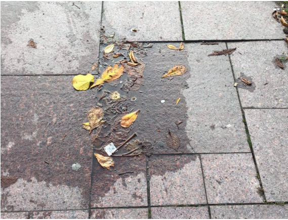
Bild 17 Av: Julia Rehnström Exempel på sättning och lutningsfel i beläggningen där vatten samlats
