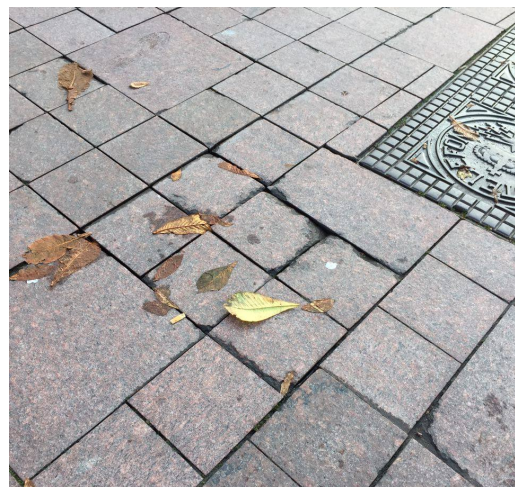
Bild 19 Av: Julia Rehnström Exempel på skadade hållar i området kring luckan för rikstelefonen
