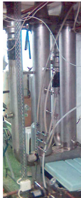
Bild 2.1: Rökgaskondensorn Skrubbersteg, värmeväxlare samt uppsamlingstank för kondensatet.
