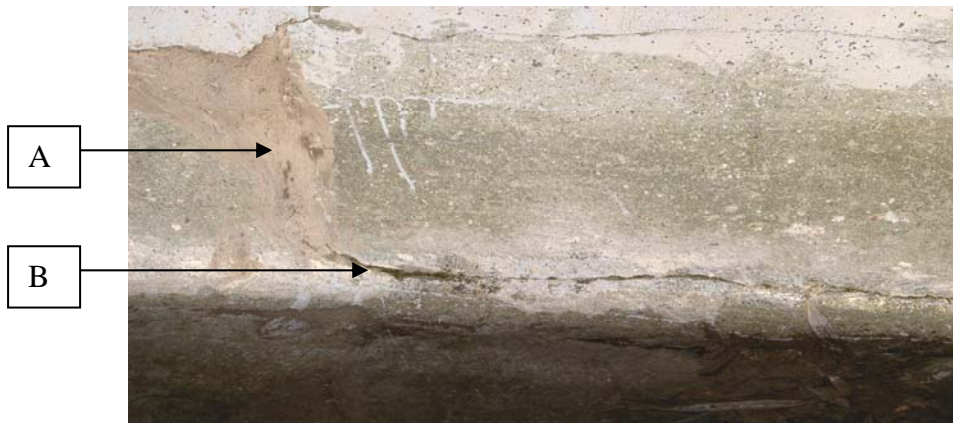
Bild 2: Sprickor och lagning
