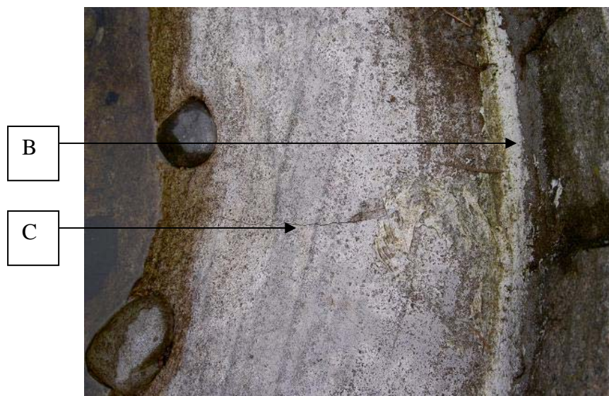
Bild 6. Spricka, högt vct.
