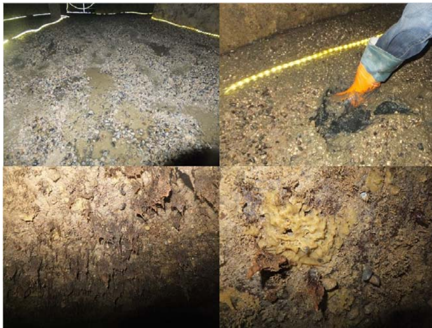
Figur 4. De översta bilderna visar golvet i norra tunneln till hjälpkylvattenpumparna. Där fanns ett cirka 10 cm tjockt lager av döda och levande musslor och skal. Bilden längst ner till vänster visar ett cirka 5–10 cm tjockt lager av påväxt i taket i tunneln. Bilden längst ner till höger visar kuddartad sötvattenssvamp ( Ephydatia fluviatilis ).
