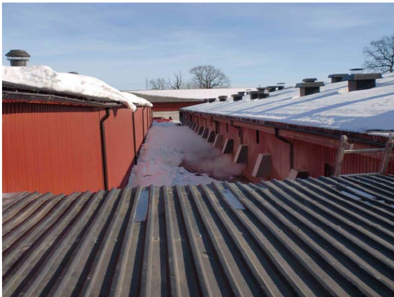
Figur 45. Under avlivningen sågs stort läckage från framför allt ventilationsöppningar i husets långsidor.
