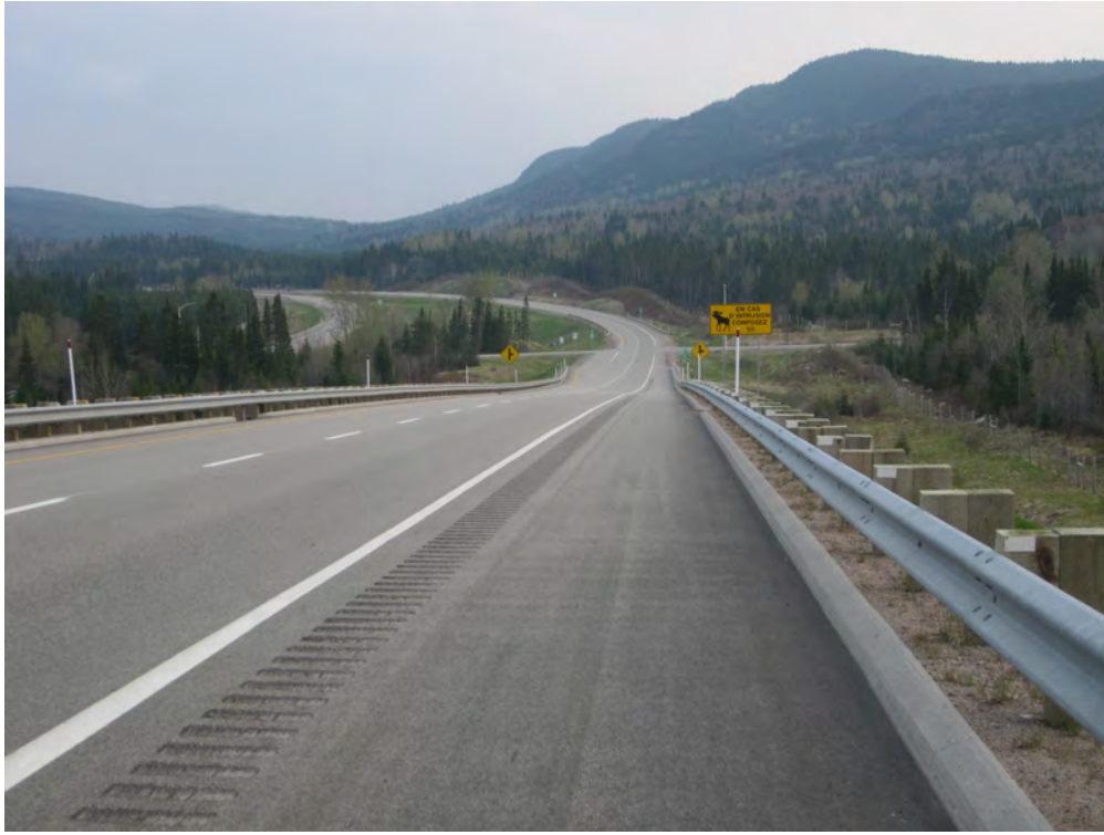
Figure 1.1 La route 175 après son élargissement dans la réserve faunique des Laurentides (Photo : Université Concordia)
