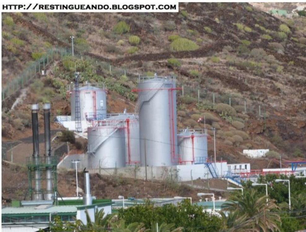
Diesel storage tanks, Llanos Blancos Plant, El Hierro
