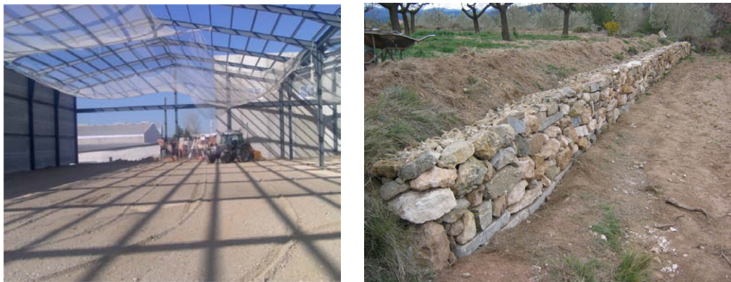
Figura 3. Nivelación del terreno para la instalación de un invernadero (izquierda) y realización de terrazas (derecha). Tomado de http://exgonval.com/servicios-3/ y https://www.social.cat
