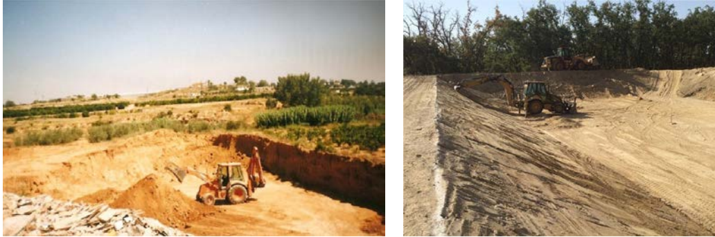
Figura 2. Vaciado para la construcción de una bodega (izquierda) y una balsa de riego (derecha). Tomado de http://exgonval.com/servicios-3/
