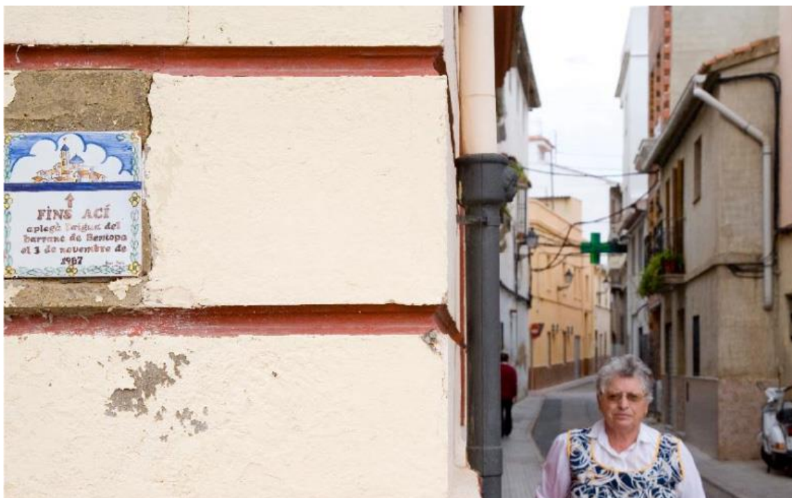
Una placa en la pared del Centre Social de Beniopa recuerda la altura de dos metros alcanzada por el agua el 3 de noviembre de 1987 (URL: https://anabelllopis.files.wordpress.com/2011/04/riada.pdf )
