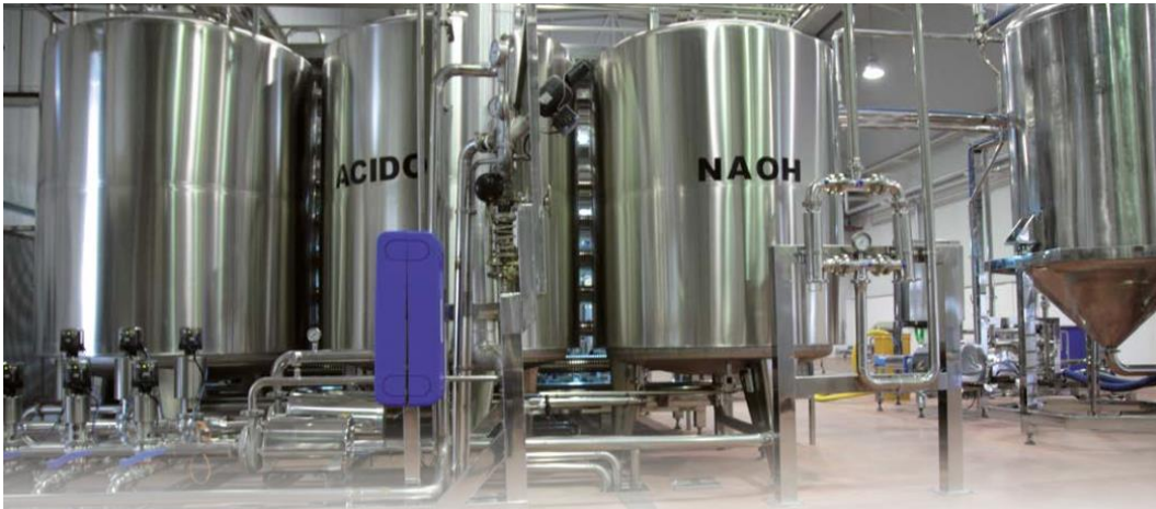
ILUSTRACIÓN 31: TANQUES DE UN SISTEMA CIP (GÉMINA PROCESOS ALIMENTARIOS S. L.).
