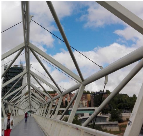
Figura 2-7. Pasarela del Museo de la Ciencia (Valladolid). Detalle del pretensado perimetral del vano principal.
