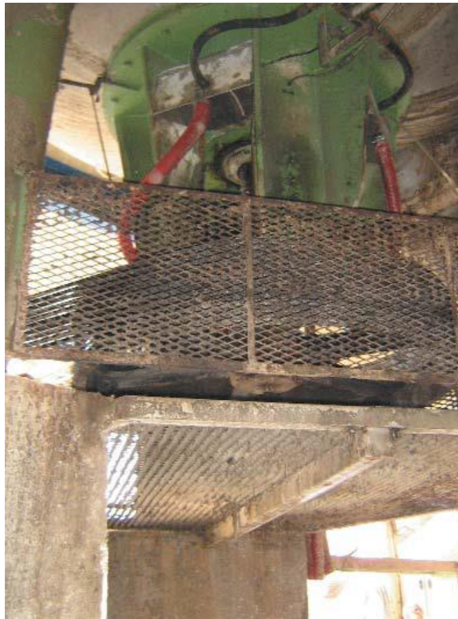
Figura V.3.9: Los resguardos instalados en este ejemplo retienen la correa en el caso que se produzca la rotura
