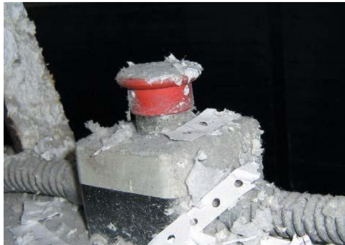
Figura V.3.3: seta de emergencia bloqueada por la acumulación de pasta.
