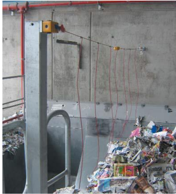
Figura V.3.5: Arco de parada de emergencia en la cinta transportadora
