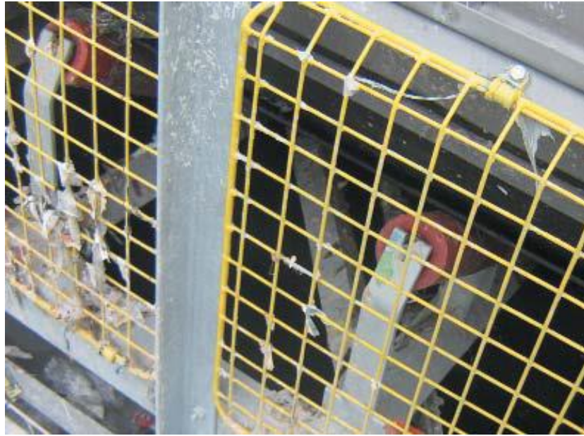
Figura V.3.7: Ejemplo de resguardo tipo rejilla que debe instalarse en estas zonas
