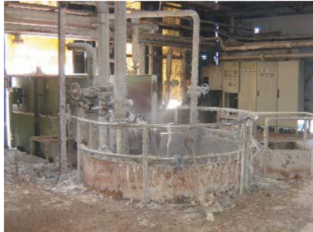
Figura V.3.2: Púlper con barandilla perimetral
