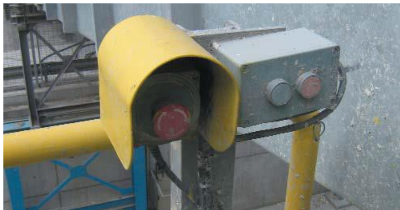
Figura V.3.4: Envolvente en torno al dispositivo de paro de emergencia.
