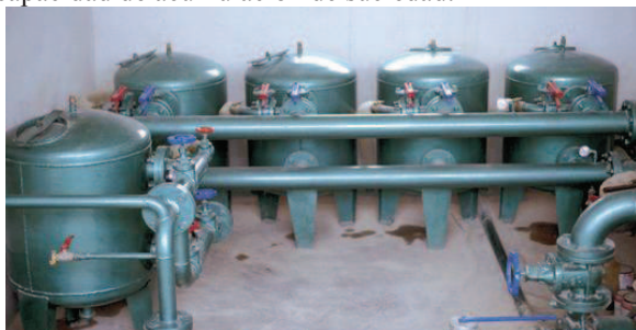
Figura 8. Batería de filtros de arena. (Centro de Formación Agraria Viñalta, 2015).
