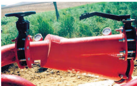
Figura 28. Válvula de compuerta a la izquierda y válvula de mariposa a la derecha de un filtro para el control del caudal. (Centro de Formación Agraria Viñalta, 2015).
