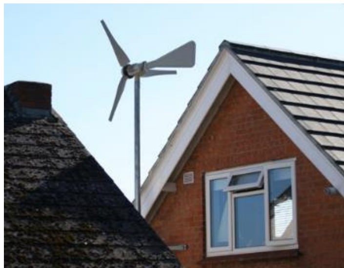
Figura 1.22. Mini aerogenerador doméstico.
