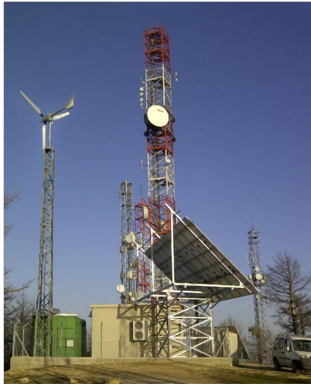
Figura 3.34. Instalación híbrida para telecomunicaciones.
