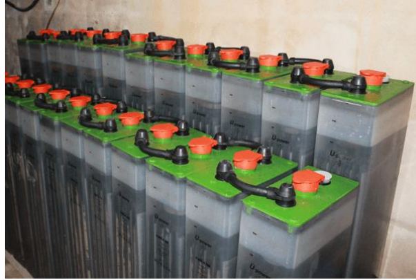
Figura 1.64. Sistema de acumulación.
