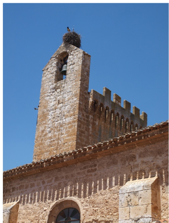
Fig.122_ Iglesia de San Pedro, Gumiel del Mercado. Torre-campanario coronado con terraza defensiva, con parapeto almenado sobre matacán corrido.
