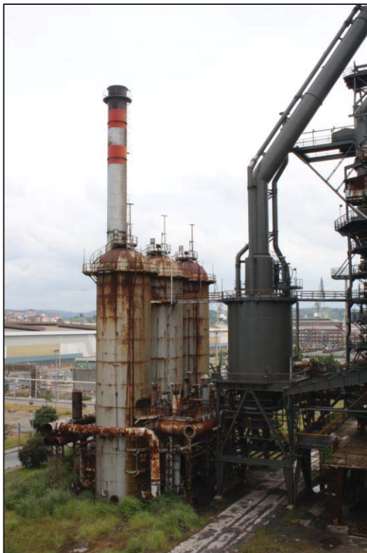
Figura 11: Detalle de elementos oxidados. Junio 2015. Imagen del autor.
