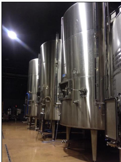
Figura 3- Depósitos isobáricos con amplias camisas de refrigeración.
