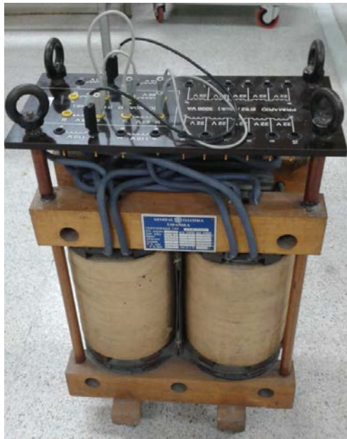
Figura 111.- Transformador ensayado (Fuente: Elaboración propia)
