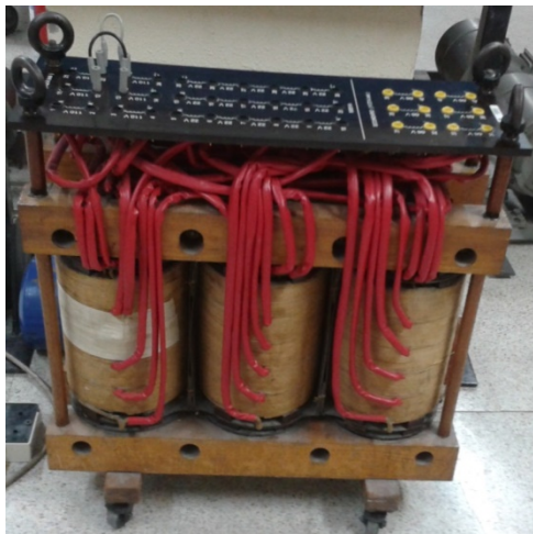
Figura 136.- Transformador ensayado (Fuente: Elaboración propia)
