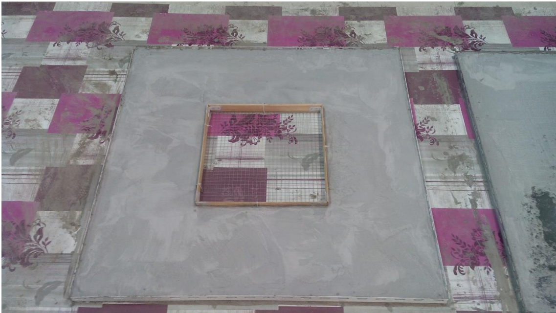
Figura 35 Parte frontal de la cámara tras antes de montar
