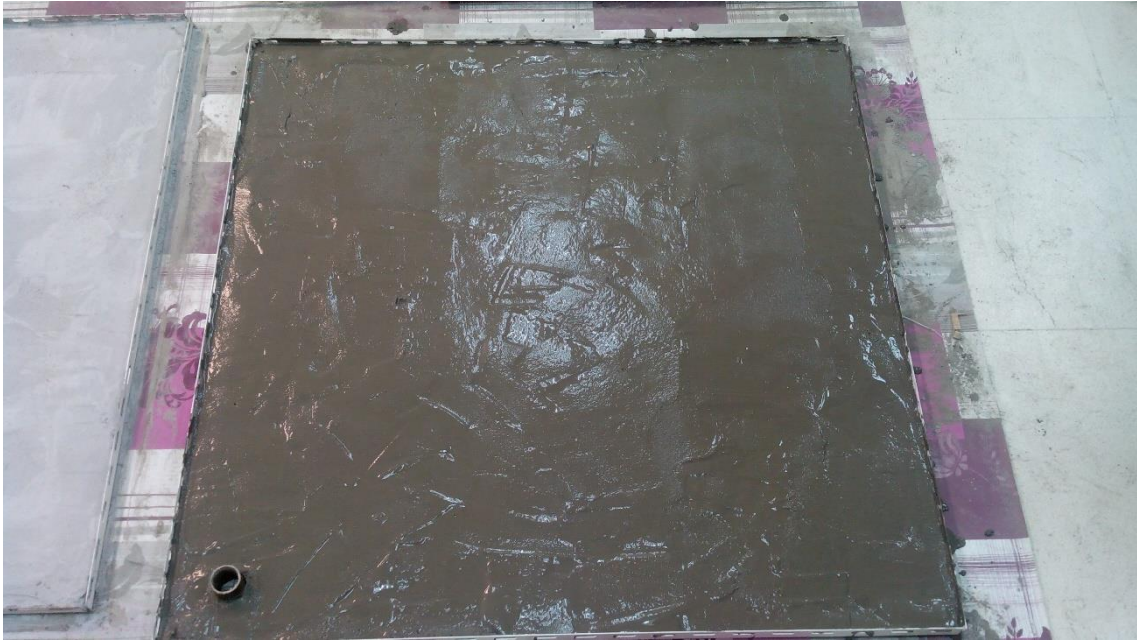
Figura 34 Estado de una de las paredes tras añadir la mezcla
