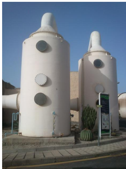
Fotografía 5: Sistema de desodorización.
