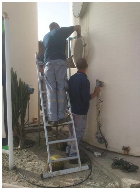
Fotografía 11: Detalle de cambio de ojeadores en la desodorización.
