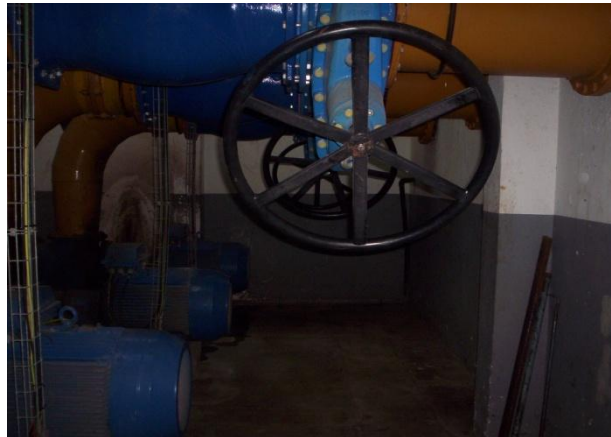
Fotografía 8: Sala de bombas de recirculación de fangos.
