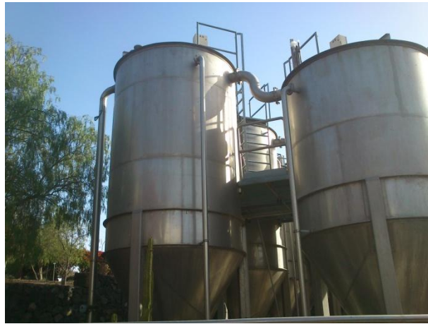
Fotografía 3: Torres de filtrado del sistema de tratamiento terciario.
