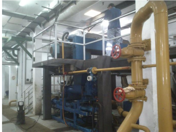
Fotografía 4: Centrifugadora de fangos.
