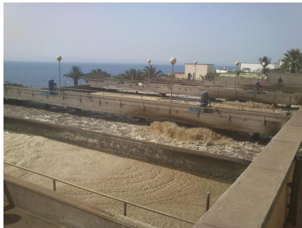
Fotografía 2: Cubas de aireación.
