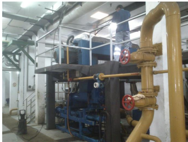
Fotografía 12: Centrifugadora de fangos.
