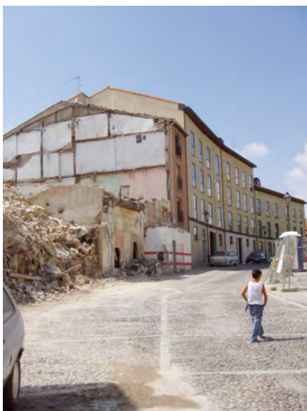
Figura 168: Ruinas y derribo en la calle de Fernán González. (Fuente: la autora)
