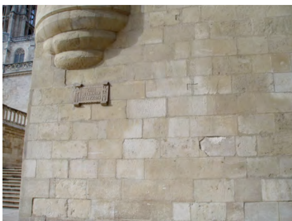
Figura 213: Manchas y grietas en los sillares del claustro bajo en la calle de la Paloma. (Fuente: la autora)
