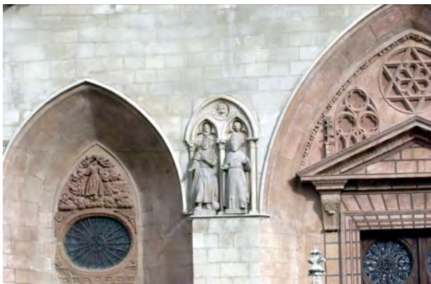
Figura 214: Manchas y pintura en la fachada de Santa María. (Fuente: Foto Fede)
