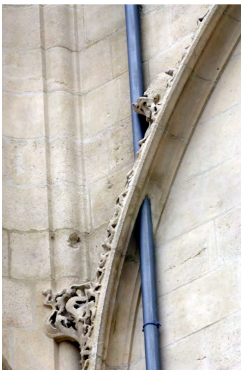
Figura 227: Detalle de la destrucción de molduras para pasar el cañal. (Fuente: la autora)
