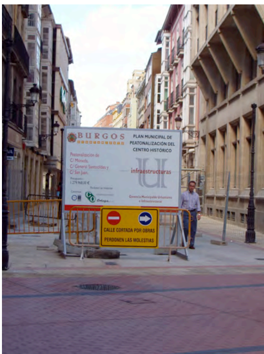
Figura 139: Burgos. Obras de “mejora” que hacen difícil la pervivencia de la actividad comercial. (Fuente: la autora)
