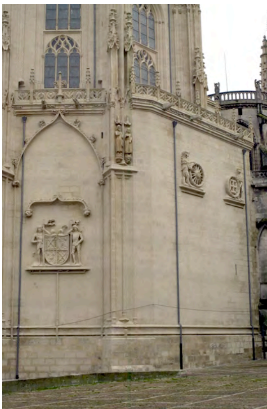
Figura 228: Lamentable aspecto de las bajantes que han sustituido a las gárgolas. (Fuente: la autora)
