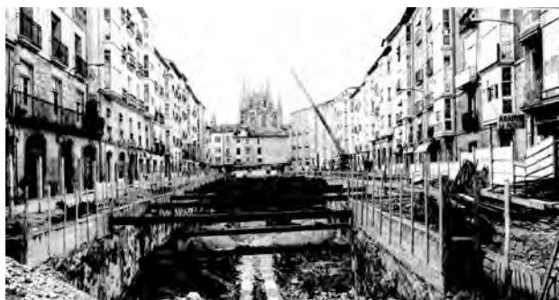
Figura 130: El aparcamiento de La Flora ha dañado la estabilidad de los edificios de la plaza. (Fuente: Diario de Burgos)
