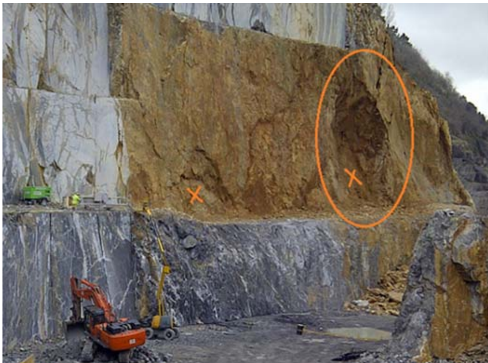
Figura 10. Desprendimiento previo en la zona final de la falla.
