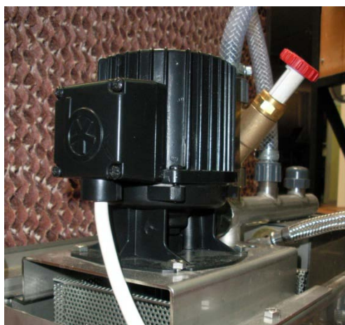
Figura VI.26.- Bomba de circulación del equipo FA6.
