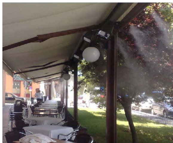
Figura VI.4.- Sistemas de pulverización de agua para refrescamiento de una terraza en el RTE de Madrid.
