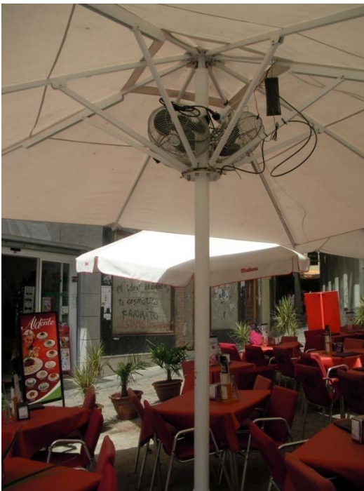
Figura VI.3.- Sistemas de pulverización de agua con ventiladores, para refrescamiento de una terraza en Toledo.
