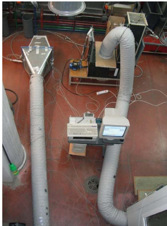
Figura VII.4.- Vista superior de la instalación de torre con batería.
