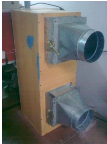
Figura IV.10.- Vista del plenum de distribución conectado a la UTA.
