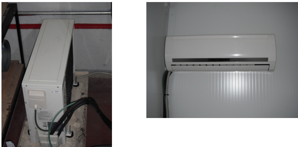
Figura IV.7.- Unidades exterior (izquierda) e interior (derecha) de la Bomba de Calor aire-aire de marca Ferroli instalada en la cámara climática.
