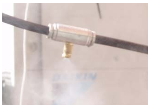
Figura VI.5.c.- Boquilla para pulverización de agua en terrazas.
