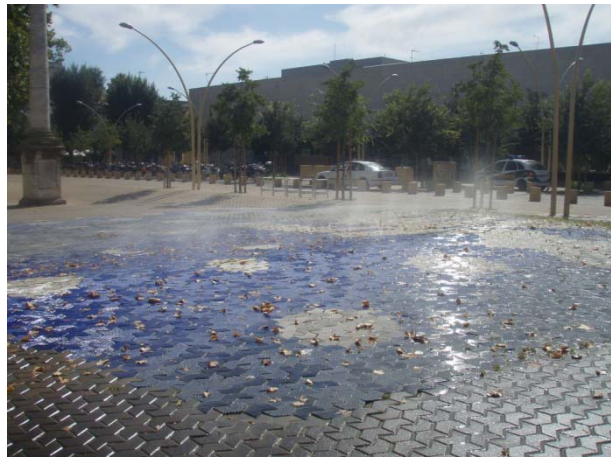
Figura VI.2.- Sistemas de pulverización de agua instalados en los adoquines de una plaza para refrescamiento en Sevilla.
