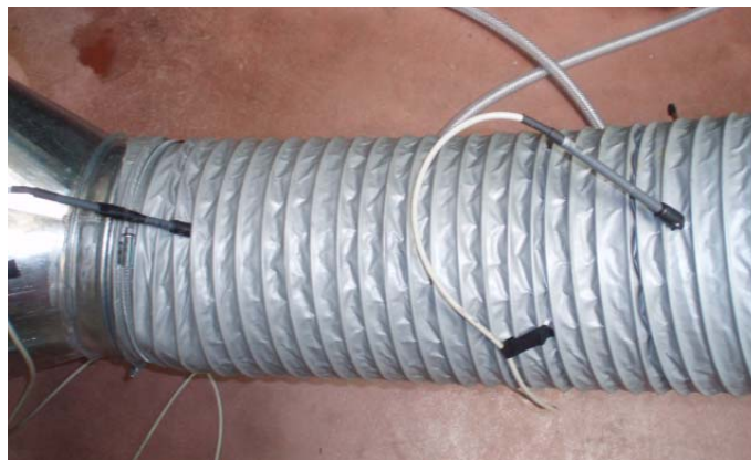
Figura IV.9.- Detalle de un conducto de aire flexible.
