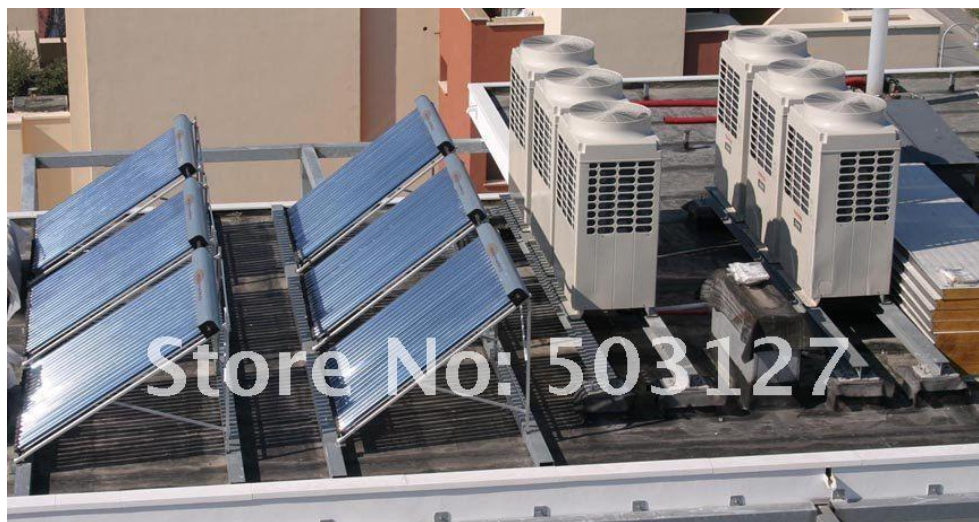
Figura 14. Instalación externa de un sistema de frío solar. Se puede apreciar colectores solares y torres de disipación de calor. Fuente: Google.
