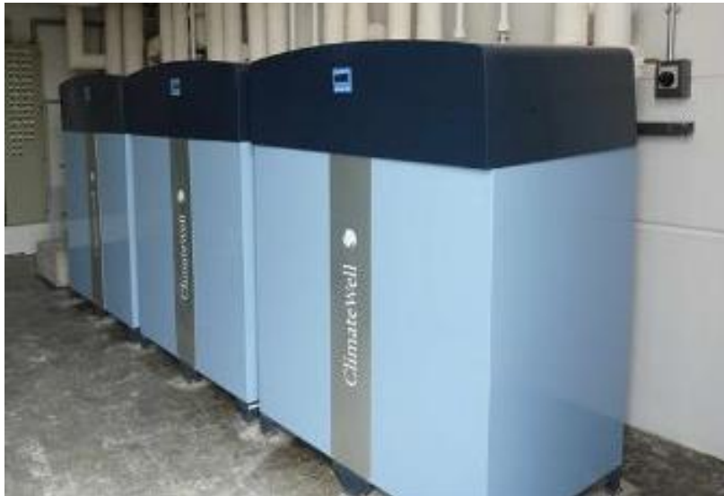
Figura 7. Equipos de aire acondicionado por absorción. [1]
