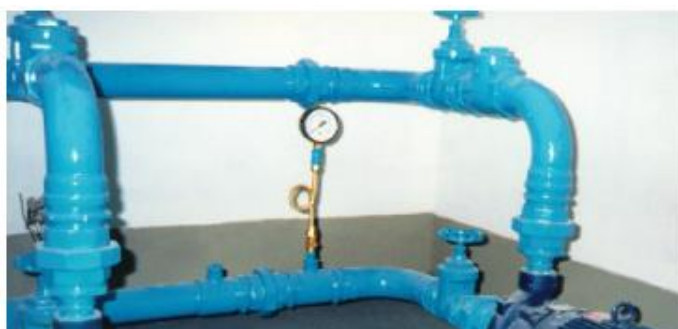
Figura 2.2 – Estação elevatória de água tratada (FUNASA, 2007)
