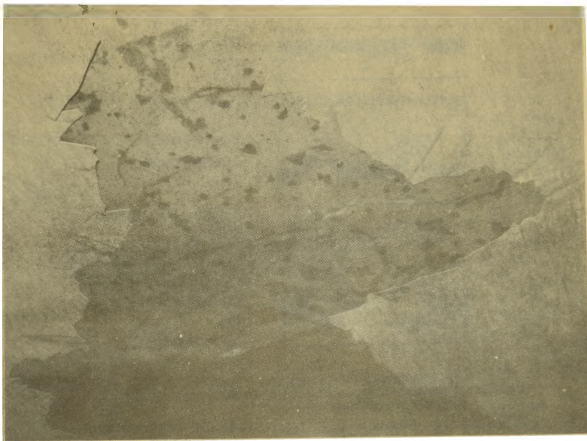
Figura 45.- Desprendimiento del revestimiento protector aplicado sobre una superficie mal preparada
