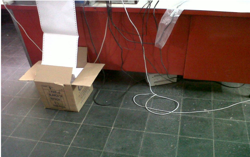
Imagen 6. Ausencia de protección correcta en el cableado
