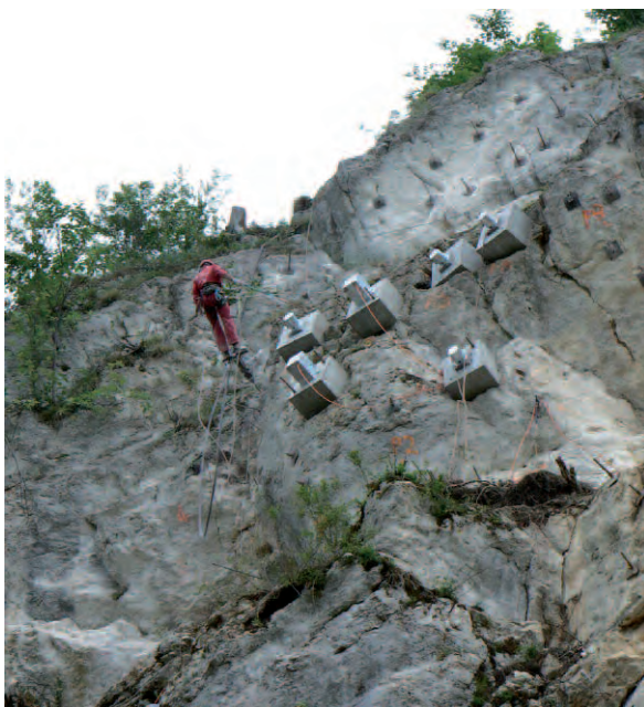
Figure 10: «jumeau», les six ancrages à droite de l'ouvrier, avec leurs appuis en béton, sont bien visibles depuis la H18; on peut également observer, à droite et au-dessus, les têtes de clous (petites plaques carrées en acier).
