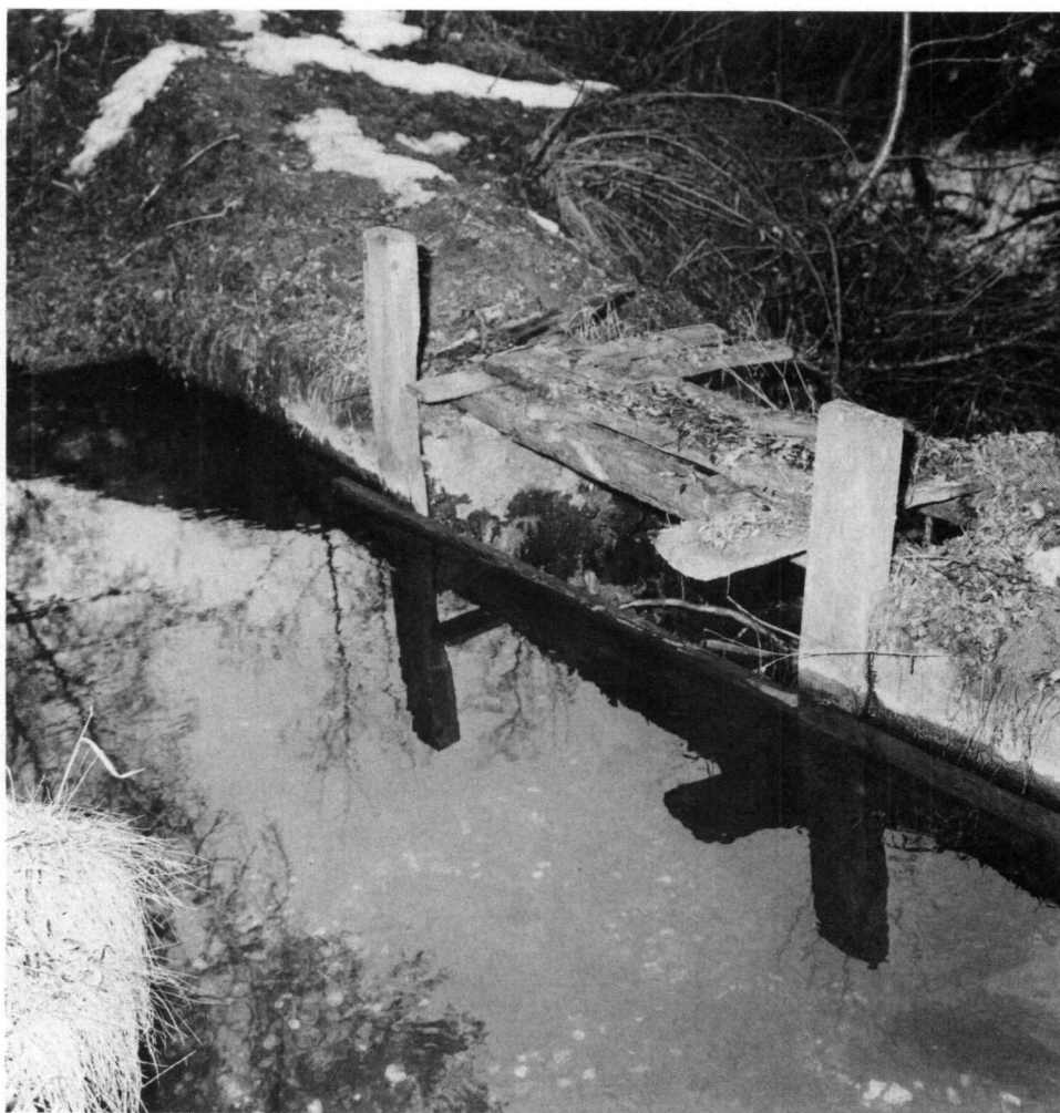
Pl. II. — La vanne du déversoir, qu'on ferme d'une simple planche. Photo Jean-Marc Biner, 1989.
