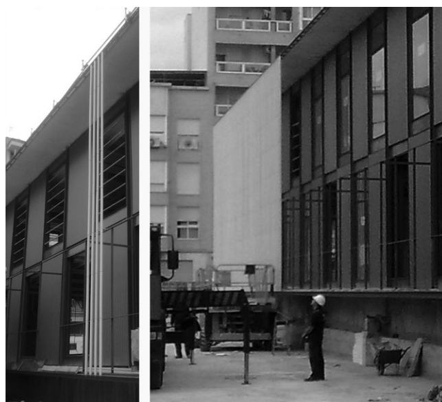
Figura 9. Fotos de puesta en obra tras instalación de ángulos superior e inferior de anclaje y sistema intermedio de arriostramiento. Cortesía de Butech.
