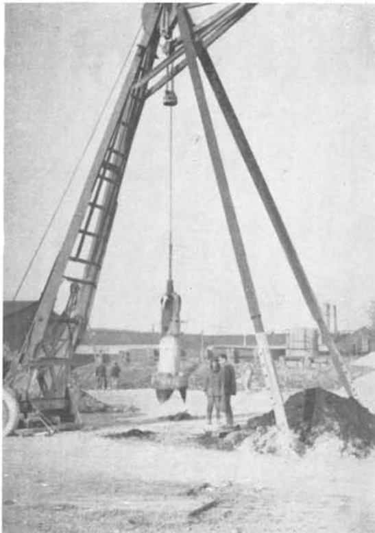
Trépano y campana, operando a percusión para apertura de pozos de cimentación.
