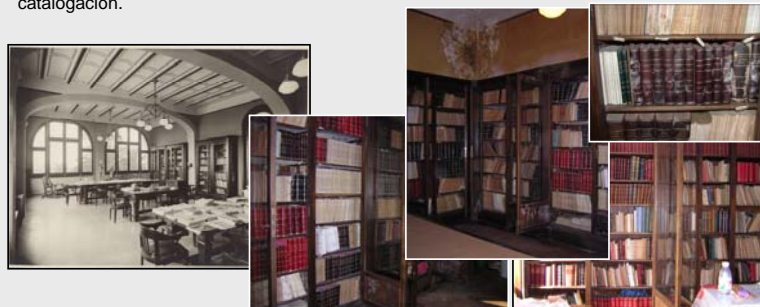
Fig. 3. Aspecto de la biblioteca a principios de siglo (izquierda) y en la actualidad (derecha). Nótese el grado de deterioro y humedad a que estaban sometidos los volúmenes.
