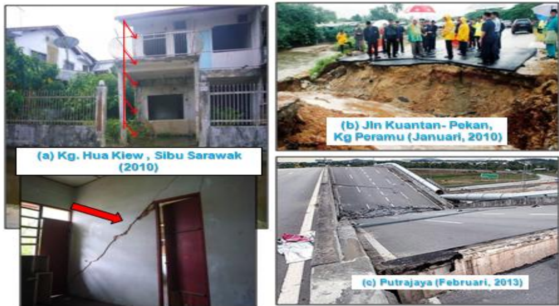
Rajah 1.2: Contoh kegagalan yang berlaku struktur binaan (a) Rumah kediaman, (b) Jalanraya dan (c) Jambatan.
