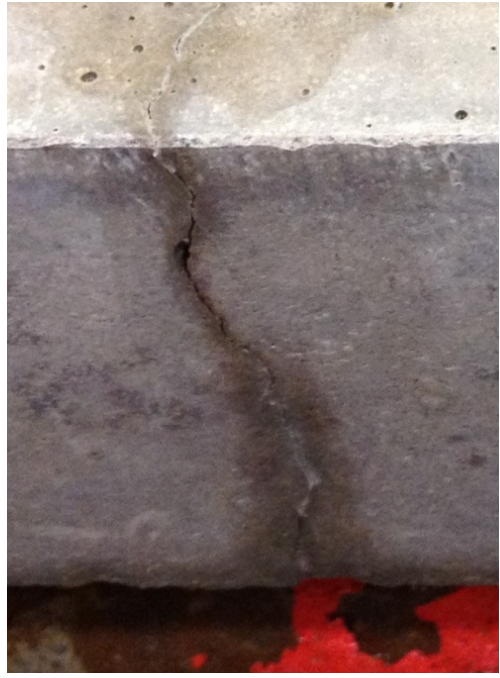
b) open crack (NaCl)
