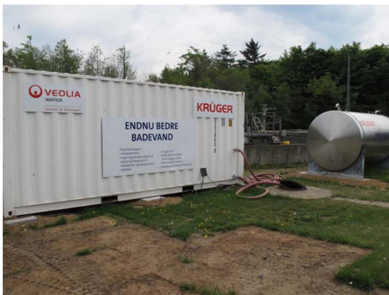
Figur 9: Test-container samt 10\text{ m}^3 tank for håndtering af overløbsvand.
