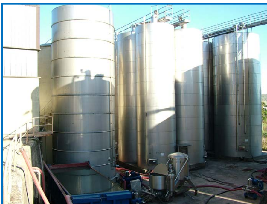
Figura 45: Vinificatori coibentati presso lo stabilimento “Vitese” 149
