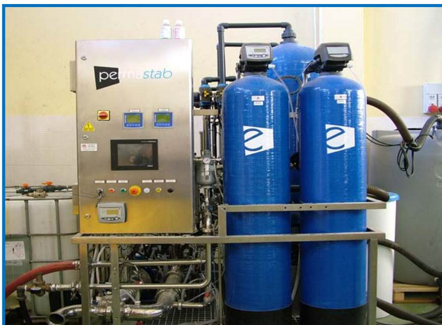
Figura 43: Filtro a scambio cationico presso lo stabilimento “Vitese” 147
