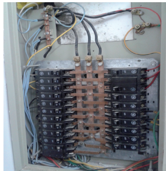
Figura 1. Painel de força antes do Retrofit. Fonte: Autor, 2017.
