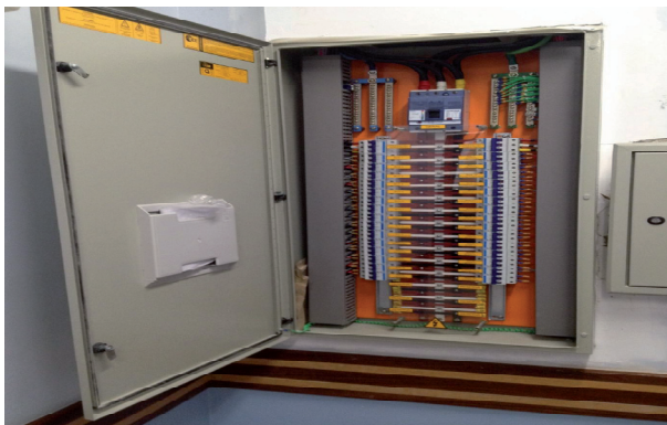
Figura 4. Novo painel de força. Fonte: Autor, 2017.
