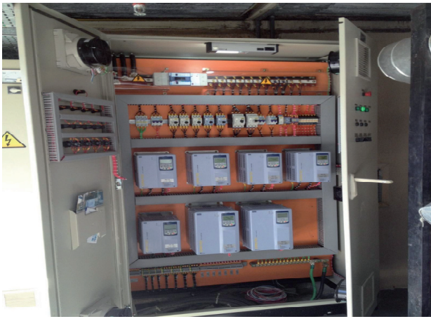
Figura 3. Novo painel de comando. Fonte: Autor, 2017.
