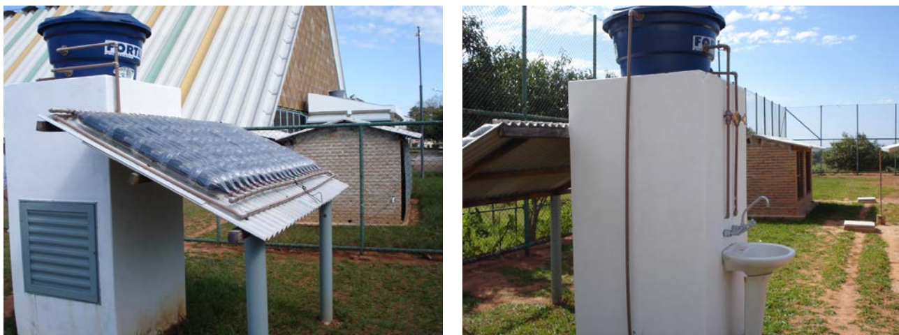
Figura 3. Aquecedor solar instalado no chão, na área experimental do Laboratório de Conforto Ambiental para exposição.
