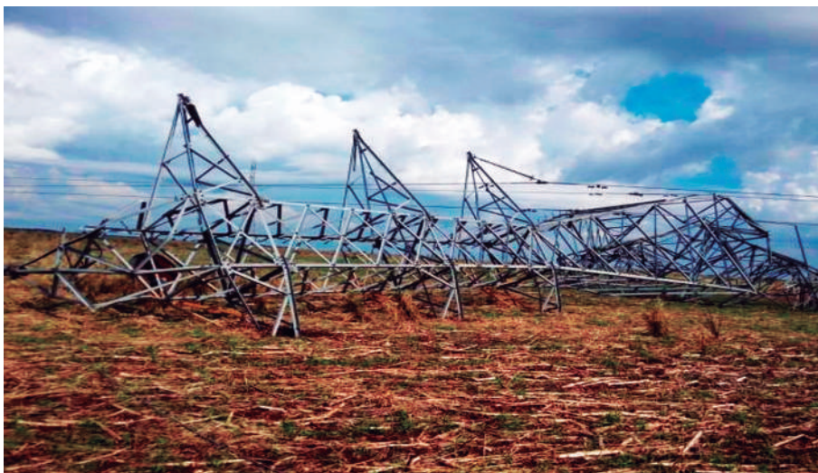
Figura 2 Torre de transmissão da Copel tombada na região de Cascavel-PR devido a ação de uma microexplosão no dia 12 de julho de 2016 às 23:30 UTC (Fonte: Copel GeT).
